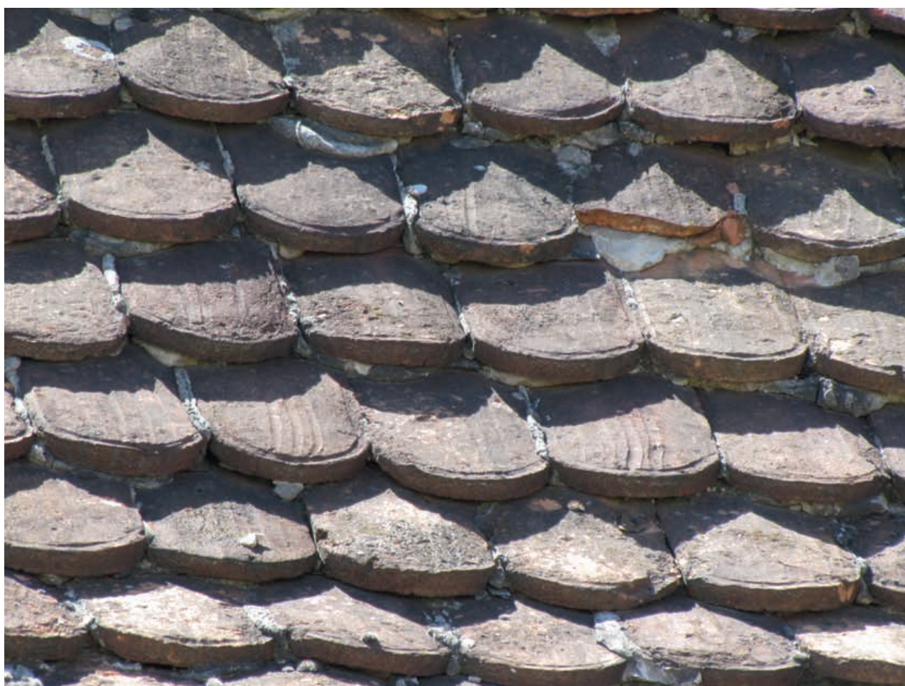
19. Milaków, kościół parafialny pw. św. Bartłomieja Apostoła, dachówki ułożone na połaci północnej korpusu kościoła (fot. A. Duda)
