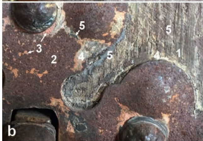
7. Starsze nawarstwienia na stolarce drzwiowej zachowały się na i przy elementach okuciowych; 1 – drewno, 1580, I; 2 – elementy żelazne, kute, od strony wnętrza kościoła mają zachowaną warstwę oksydowania, jak wyżej; 3 – zabezpieczająca warstwa miniowa, XIX w. ?, II; 4 – żółta warstwa malarska, jak wyżej; 5 – czarna warstwa malarska (okucia) i brązowa warstwa malarska, XX w., III
