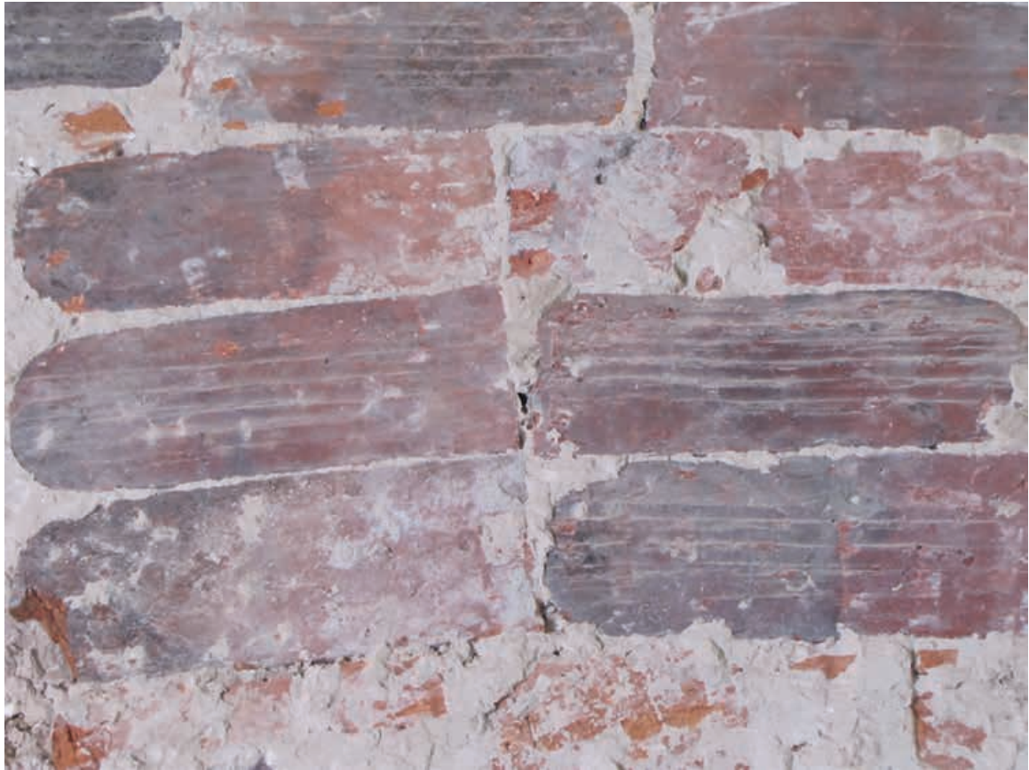
14. Miłaków, dachówki wykorzystane przy szpaldowaniu ściany jednego z pomieszczeń dworu (fot. A. Duda)
