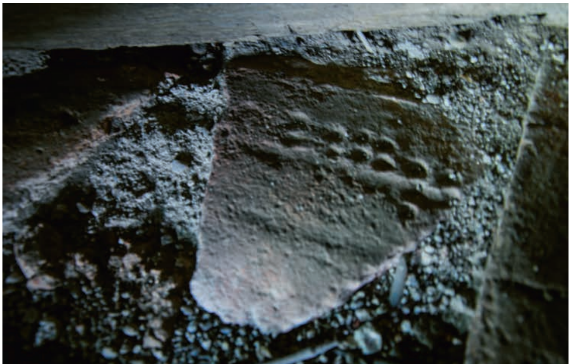
9. Miłaków, kościół parafialny pw. św. Bartłomieja Apostoła, zachowany fragment dachówki z odciskiem punktowym, wmurowany w stopnicę schodów prowadzących na wieżę (fot. A. Duda)
