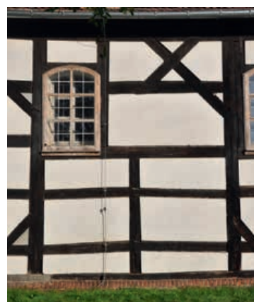
12. Kościół w Kalsku. Fragment zmienionej konstrukcji szkieletowej w elewacji południowej (fot. U. Schaaf)
