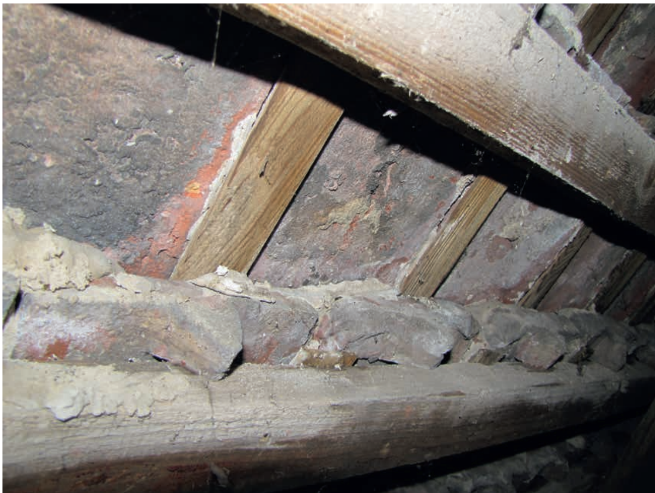
24. Miłaków, kościół parafialny pw. św. Bartłomieja Apostoła, sposób montażu dachówek na północnej połaci nad korpusem głównym, widoczne drewniane podkładki uszczelniające pokrycie (fot. A. Duda)
