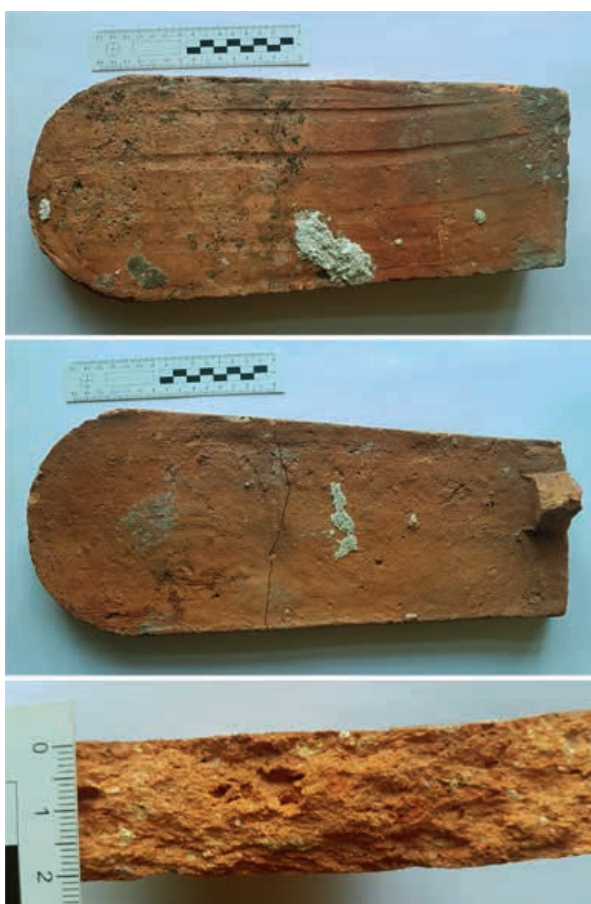
12. Miłaków, kościół parafialny pw. św. Bartłomieja Apostoła, jedna z nielicznych dachówek klinowych. Na powierzchni widoczna czerwona warstwa kolorystyczna (fot. A. Duda)
