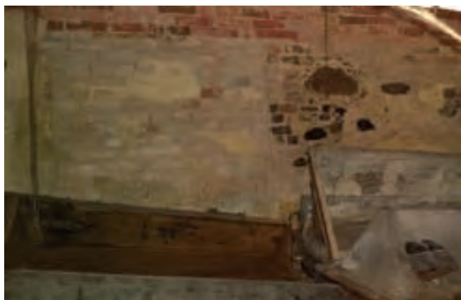
Ryc. 8. Borów Wielki. Kościół pw. Świętego Wawrzyńca. Krypta w mauzoleum rodziny von Unruh z 1821 roku. Widoczne zamurowanie dawnego otworu wejściowego w południowej ścianie prezbiterium, fot. K. Błaszczyk
