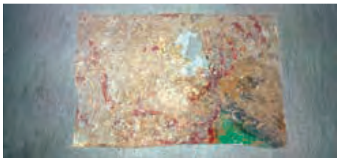
Ryc. 40. Borów Wielki. Kościół pw. Świętego Wawrzyńca. Odkrywka na północnej ścianie prezbiterium z fragmentem gotyckiej lub renesansowej polichromii, fot. K. Błaszczyk
