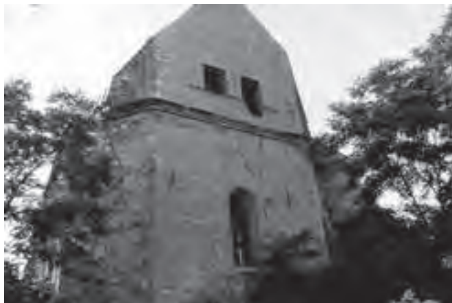
Ryc. 2. Prezbiteryum kościoła. Widoczny pierwotny zarys okna wschodniego, fot. M. Paszowska, archiwum Wojewódzkiego Urzędu Ochrony Zabytków w Zielonej Górze
