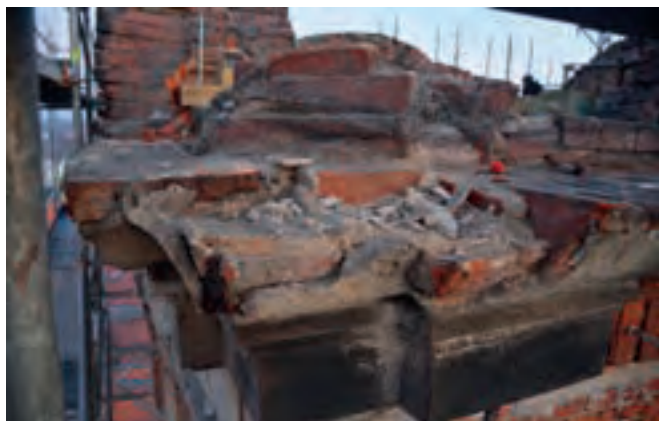
Ryc. 15. Żary, uszkodzone naroże gzymsu koronującego wtórnie wykonane w technice murowanej, fot. A. Gutka, 2020
