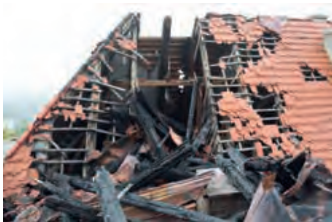
Ryc. 9. Żary, zniszczony dach nad skrzydłem południowo-zachodnim zamku, fot. A. Gutka, 2019
