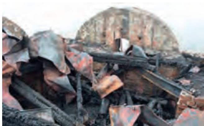
Ryc. 7. Żary, wieża zamkowa po pożarze, fot. A. Gutka, 2019
