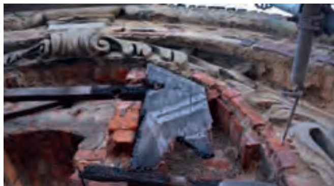
Ryc. 8. Żary, zniszczona przez pożar tarcza zegarowa na wieży zamkowej, fot. A. Gutka, 2019
