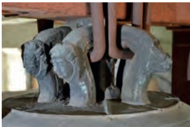
2. Mocowanie dzwonu do stalowego jarzma bez podkładki akustycznej. Na kabłąkach korony widoczne odkształcenia wtórne, fot. M. Poźniak, M. Tureczek
