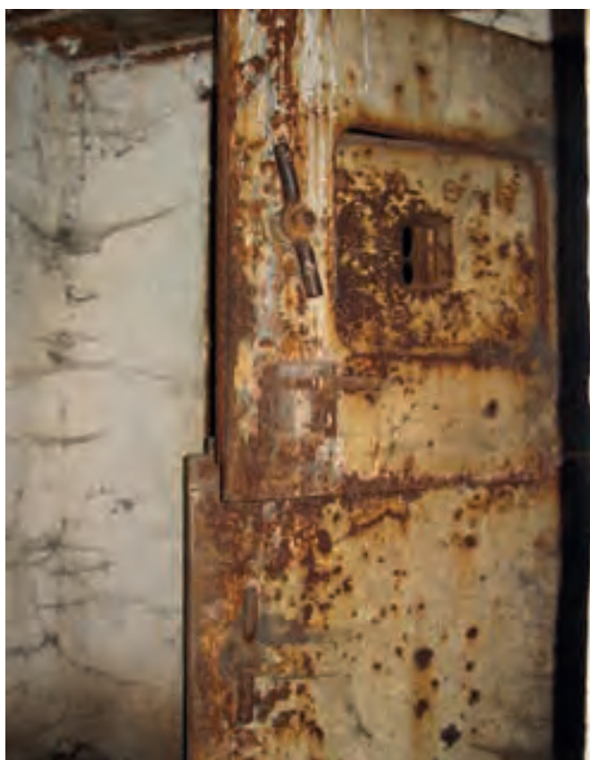
Ryc. 2. Niezachowane drzwi stalowe w Wasserschloss 602, fot. G. Urbanek
