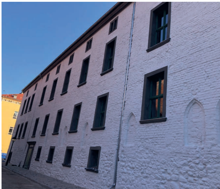
Ryc. 2b Szprotawa, dawny klasztor magdalenek, widok od północnego-zachodu – stan po pracach, fot. A. Legendziewicz
