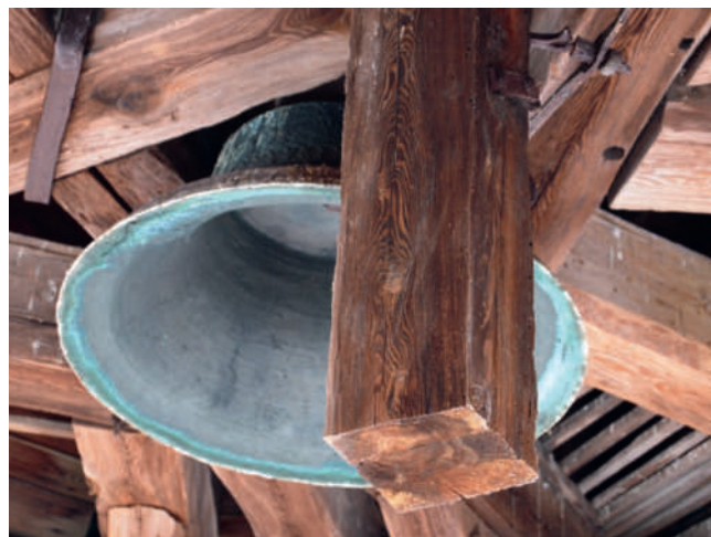
Ryc. 2. Elementy konstrukcji stropu latarni wieży południowej oraz pozostałości mechanizmu zegarowego, stan 18.08.2020 r., fot. M. Tureczek
