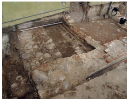
Ryc. 14. Szprotawa, dawny klasztor magdalenek, woj. lubuskie. Wykop II – odsłonięte relikty architektury późnośredniowiecznej i nowożytnej, pomieszczenie 8, fot. S. Kałagate
