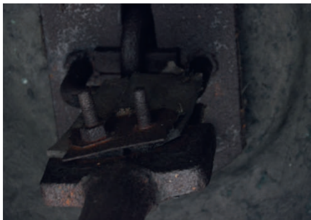
Ryc. 10. Uszkodzony pas i mocowanie serca, fot. M. Tureczek 2020 r.
