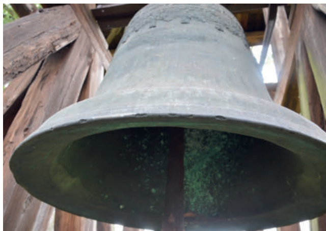
Ryc. 11. Wyszczerbienia krawędzi, widoczne na sercu miejsce uderzenia o krawędź oraz zużycie kryzy, fot. M. Tureczek 2020 r.
