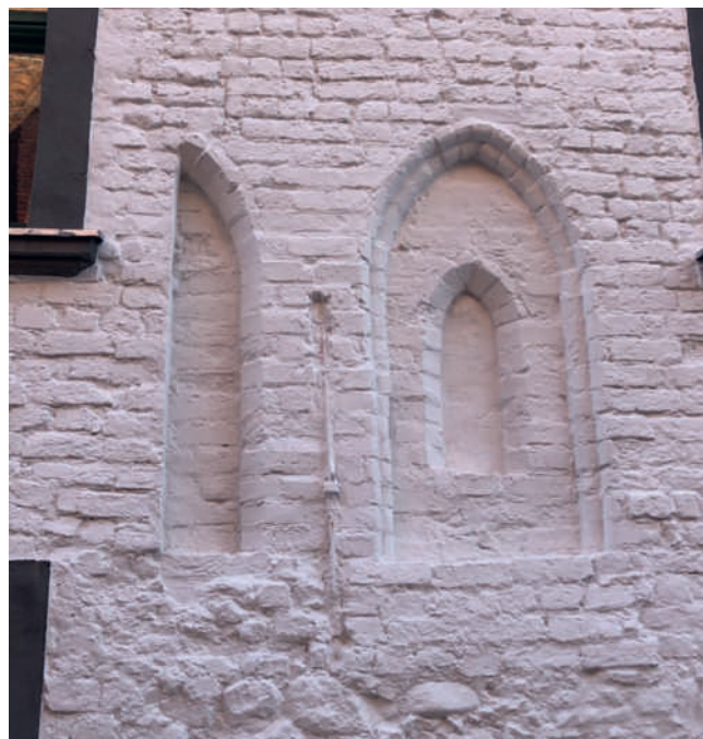
Ryc. 5b. Szprotawa, dawny klasztor magdalenek, elewacja północna, detal blend gotyckich – stan po pracach, fot. A. Legendziewicz
