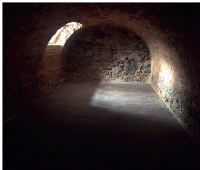
Ryc. 9c. Szprotawa, dawny klasztor magdalenek, piwnica, pasmo zachodnie, wnętrze komory ku zachodowi – stan po pracach, fot. A. Legendziewicz
