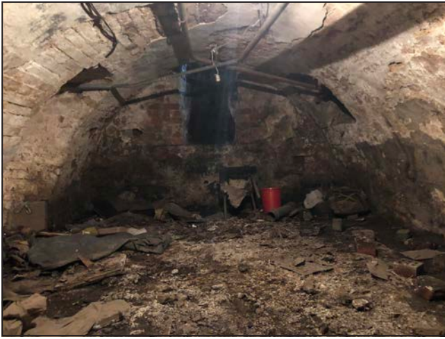
Fot. 7. Zielona Góra, parcela przy ul. Artura Grottgera 1, kamienica frontowa, piwnice, komora traktu frontowego, widok ku południowi
