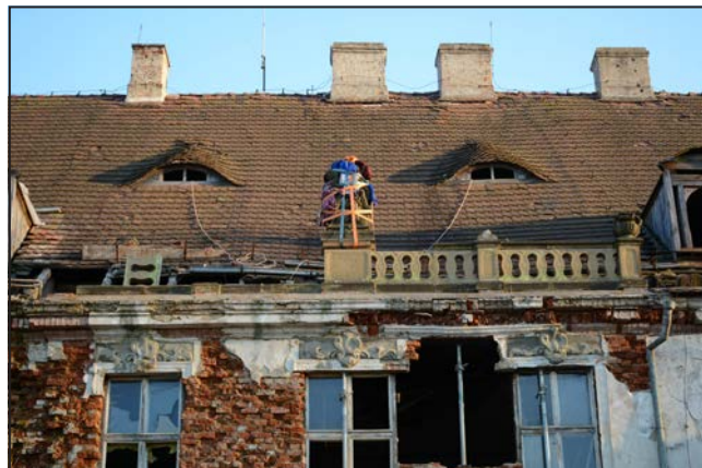
Fot. 6. Elewacja frontowa pałacu w trakcie ewakuacji kamieniarki, po częściowym zawaleniu się ściany. Fot. A. Gutka, 2018 r.
