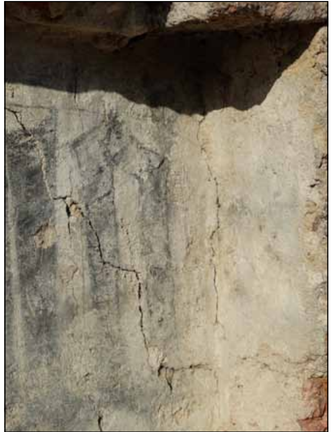
Fot. 7. Widok na fragment zachowanej prawej wnęki z inskrypcją z odspojeniami i pęknięciami tynków wapiennych. Fot. M. Domańska-Tomczyk.
