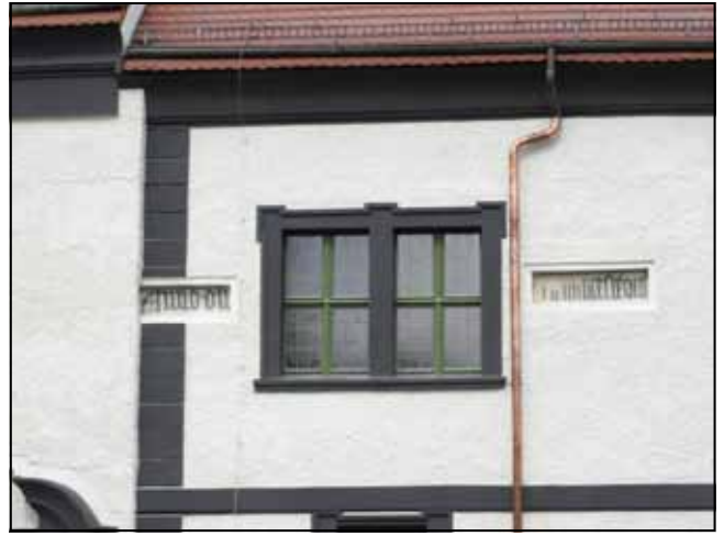
Fot. 27. Elewacja płd. Widok na fragment elewacji płd. w miejscu inskrypcji. Stan po konserwacji. Widoczne tynki wapienne, nakrapiane z odtworzoną kolorystyką i odkryte inskrypcje po wykonaniu konserwacji techniczno-estetycznej. Fot. M. Domańska-Tomczyk.
