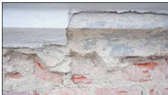
Fot. 16. Świadek tynku XIX w. odkryty na elewacji wsch., zach. i półn. Fot. M. Domańska-Tomczyk.
