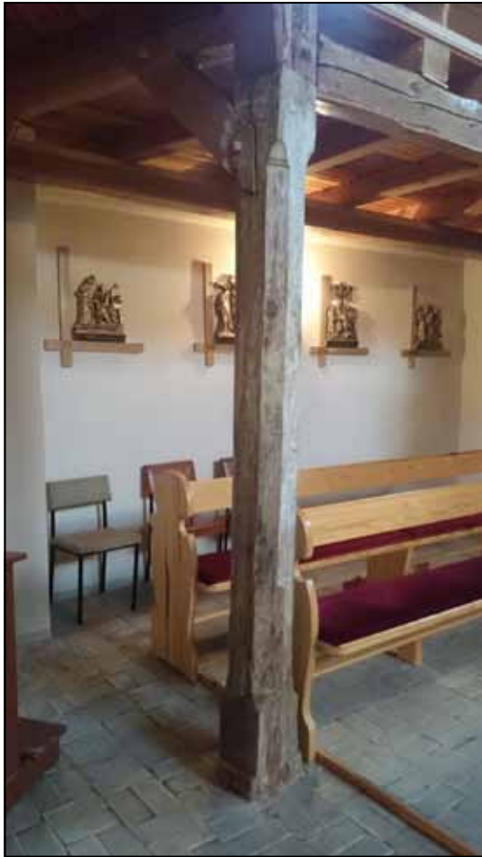
Il. 13. Widok na słup podpierający empore. Zdjęcie przed konserwacją i restauracją. Fot. K. Wantuch-Jarkiewicz.
