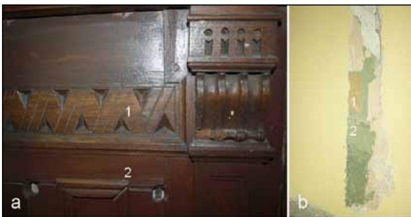
Fot. 4. Pomieszczenie z fot. 2. a) Boazerie zostały wtórnie odświeżone brązową lakieroboją w trakcie jednego z ostatnich remontów wnętrza. b) Widoczna historyczna, prosta, olejna dekoracja malarska na ścianach, pod spodem starsza, zachowana szczątkowo, również olejna.
