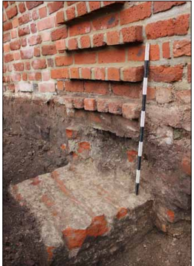
Fot. 13. Międzyrzecz, zamek (odcinek północny, część zachodnia) – odsłonięty fragment fundamentu; widok od południowego wschodu. Fot. A. Indycka.
