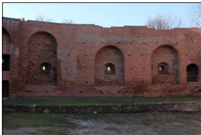
Ryc. 10. Międzyrzecz, zamek – wewnętrzne lico muru obwodowego (część zachodnia); stan po wykonaniu prac remontowo-konserwatorskich. Fot. A. Indycka.
