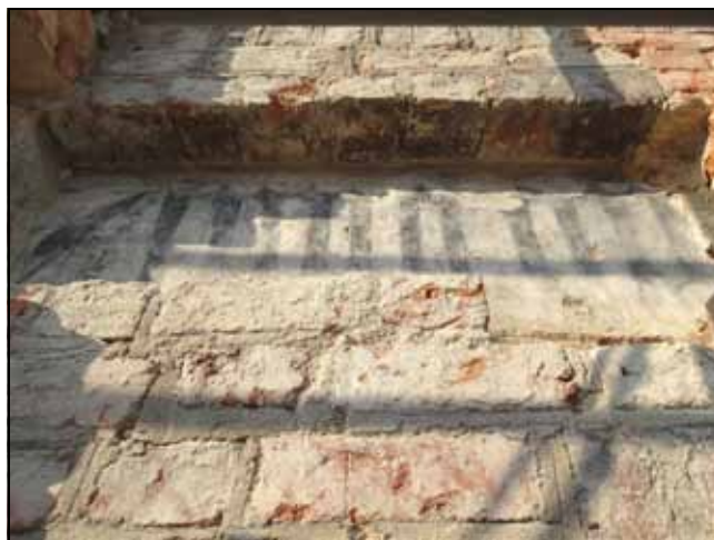
Fot. 21. Fragment inskrypcji na elewacji płd. nad pierwotną bramą wjazdową na średniowieczny zamek. Stan w trakcie prac po usunięciu zamurowania. Na powierzchni zabielenie z zaprawy wapiennej oraz liczne ubytki i pęknięcia. Fot. M. Domańska-Tomczyk.
