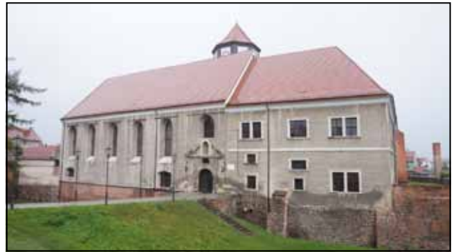
Fot. 36. Zamek w Koźuchowie. Elewacja płd. Stan przed konserwacją. Widoczne nieestetyczne tynki cementowe na całej powierzchni ściany, zabrudzenia wątku kamiennego i ceglany, zabrudzenia powierzchniowe, zacieki i ubytki. Fot. M. Domańska-Tomczyk.
