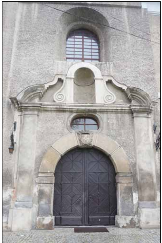
Fot. 32. Zamek w Koźuchowie. Elewacja płd. Stan przed konserwacją. Widoczne zabrudzenia powierzchniowe tynków oraz kamiennego portalu z licznymi ubytkami. Fot. M. Domańska-Tomczyk.
