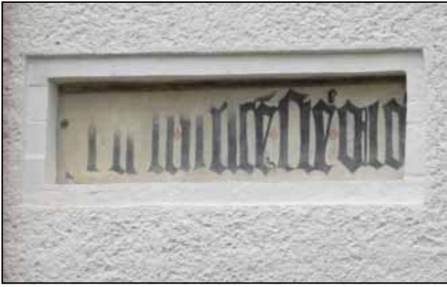
Fot. 24. Fragment inskrypcji na elewacji płd. nad pierwotną bramą wjazdową na średniowieczny zamek. Stan po scaleniu kolorystycznym uzupełnień. Fot. M. Domańska-Tomczyk.
