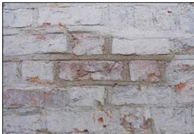
Fot. 1. Widok na fragment wątku na elewacji południowej, strona wschodnia ściany. Widoczny wątek gotycki. Fot. M. Domańska-Tomczyk.
