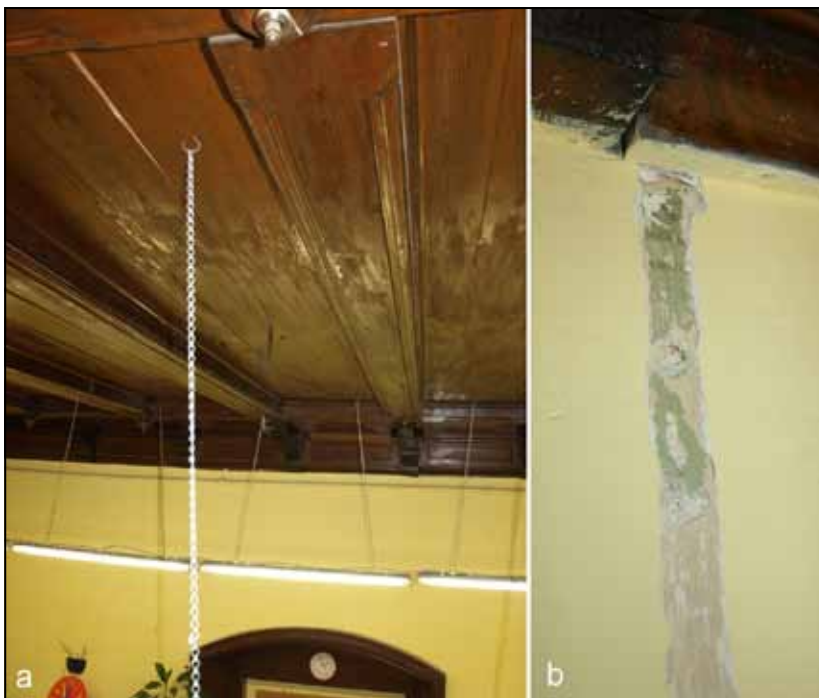
Fot. 3. Na stropie pomieszczenia (fot. 2) widać wtórną warstwą lakierniczą o nierównym połysku. Ściany były oryginalnie pomalowane farbą olejną.
