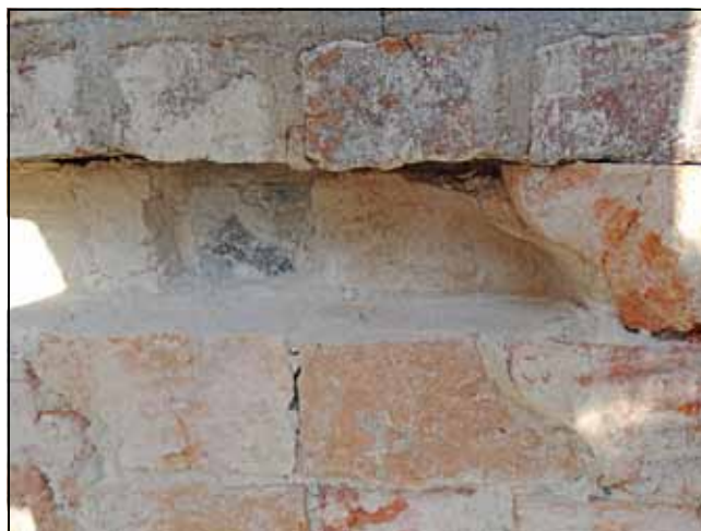
Fot. 4. Widok na fragment muru z zamurowaniem, podczas usuwania cegły profilowanej i odsłaniania XVI w. inskrypcji. Fot. M. Domańska-Tomczyk.
