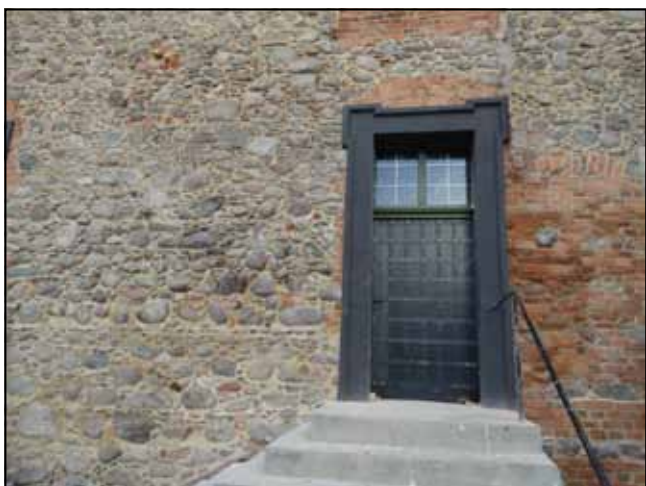
Fot. 20. Elewacja zach. Widok ogólny. Stan po konserwacji. Widoczne tynki wapienne, nakrapiane z odtworzoną kolorystyką oraz stolarką okienną. Wyeksponowany watek kamienno-ceglany w dolnej części ściany. Nowa stolarka drzwiowa. Fot. M. Domańska-Tomczyk.
