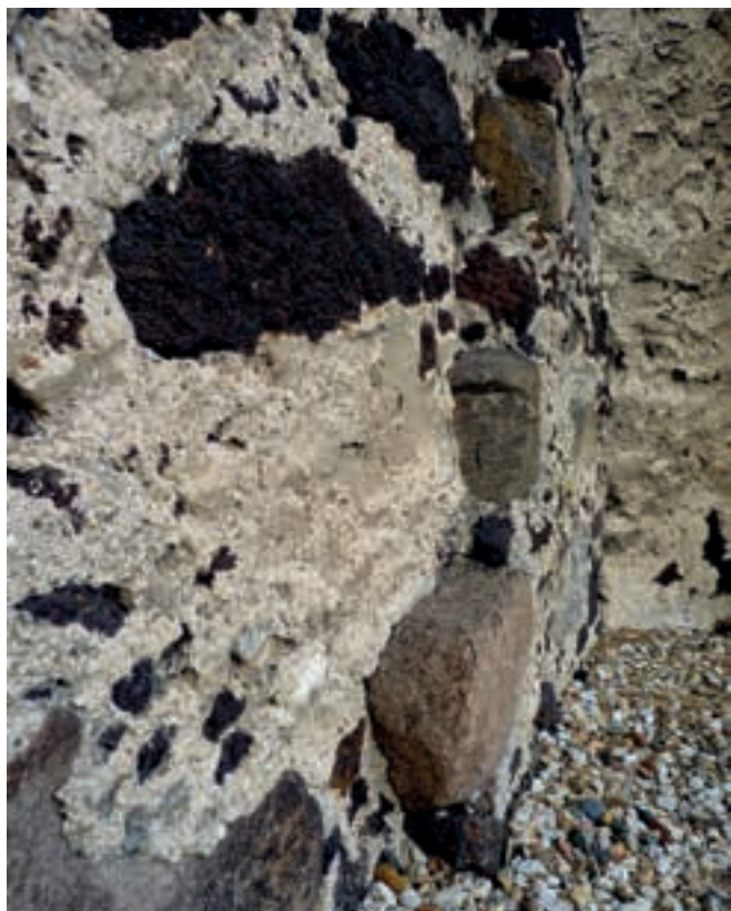
Fot. 2. Nieregularność pomiędzy trójbocznym zamknięciem a ścianą zakrystii. Fot. D. Kwaśniak
