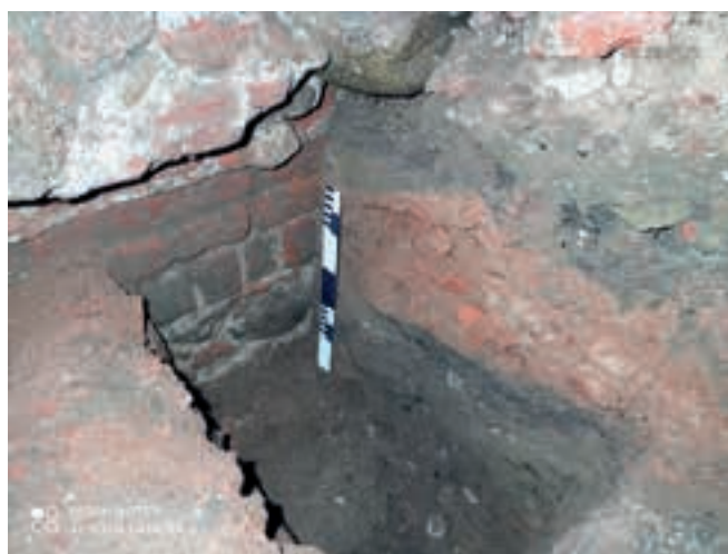
Fot. 20. Sondaż „C”. Rolka wyrównawcza w dolnej partii XVIII-wiecznego fundamentu pod kolumnę (konstrukcja „C”). Ujęcie od NE. Fot. P. Banaszak
