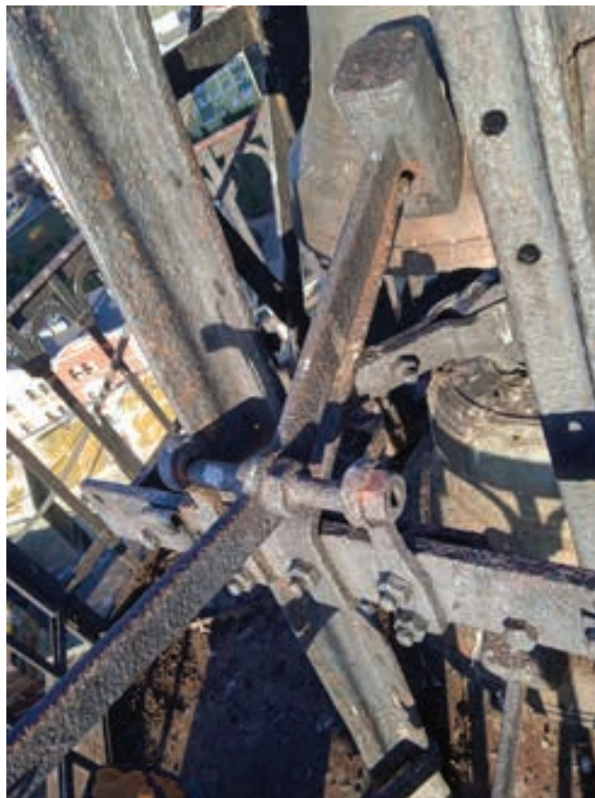
11. Bijak pobudzający wraz z amortyzatorem (widoczna korozja na elementach żelaznych). Fot. M. Tureczek
