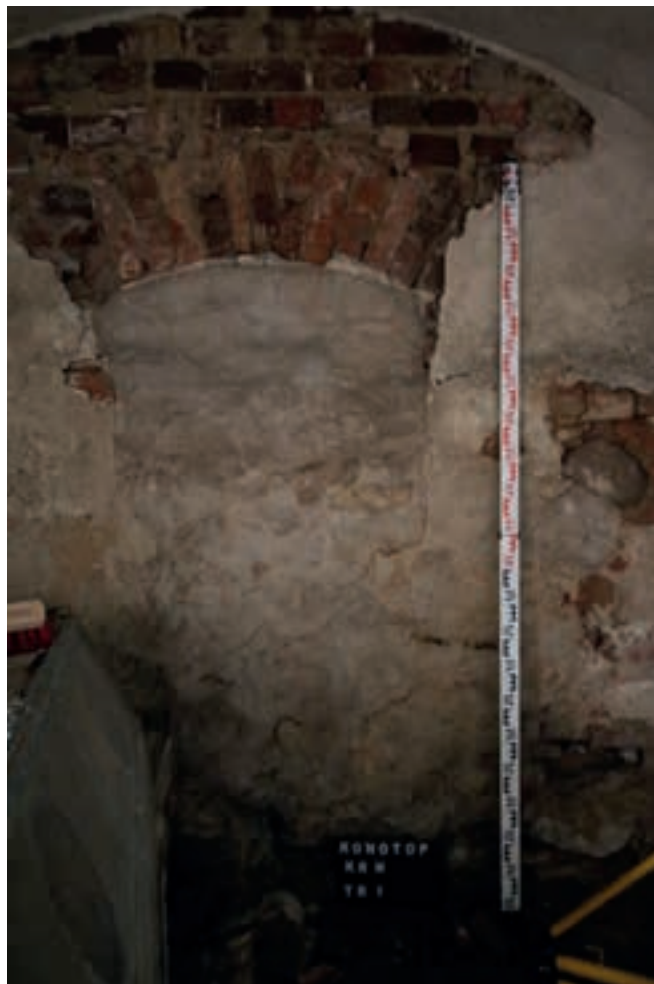
Ryc. 4. Zamurowane okno krypty odsłonięte przez spadający ze ścian tynk. Fot. J. Gawroński
