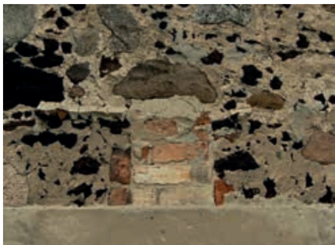
Fot. 3. Relikt nieukończonego okna wschodniego. Fot. D. Kwaśniak
