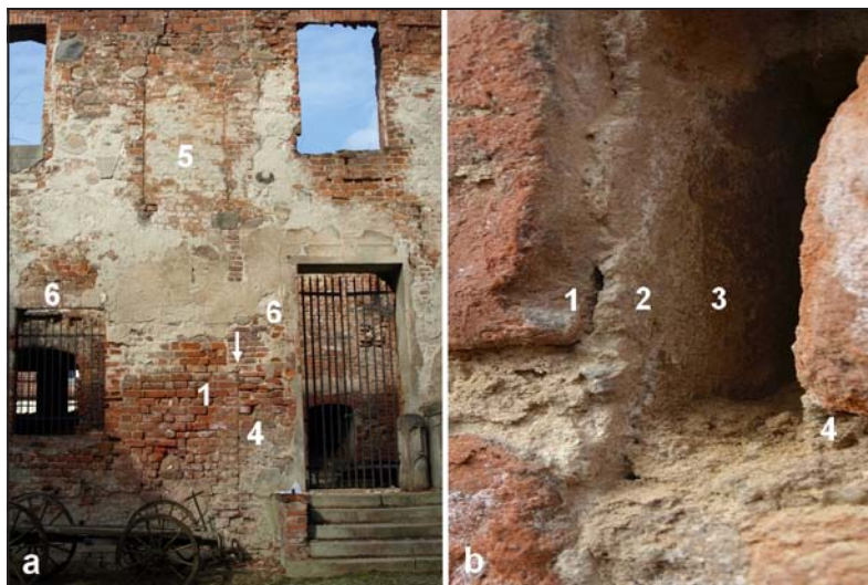
Fot. 1. Fragment elewacji południowej skrzydła północnego (a); odkrywka na styku otworu drzwiowego z końca XV lub początku XVI wieku oraz jego zamurowania, prawdopodobnie datowanego na koniec XVI wieku, obszar jak wyżej (b) 1 – mur ceglano-kamienny, 1510 (?), IV faza; 2 – tynk wapienno-piaskowy, jak wyżej; 3 – pobiała wapienna z zabrudzeniami powierzchniowymi i zmianami strukturalnymi świadczącymi o dłuższej ekspozycji, jak wyżej; 4 – zamurowanie ceglane pierwotnego otworu drzwiowego, 1571-95, V faza; 5 – zamurowanie późnogotyckiego otworu okiennego powstałego około 1510 roku, wykonane w ramach jednej z przebudów i związanej z tym zmiany lokalizacji otworów okiennych. Prawdopodobnie jest to przebudowa V lub VI fazy chronologicznej; 6 – przemurowania z końca XIX i początku XX wieku. Fot. P. Celecka.
