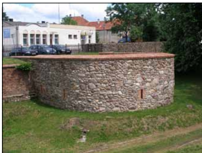
Ryc. 30. Koźuchów, ul. Obywatelska, dz. nr 491/2, basteja, widok na zrekonstruowany obiekt od strony SW, czerwiec 2016 roku. Fot. J. Lewczuk.
