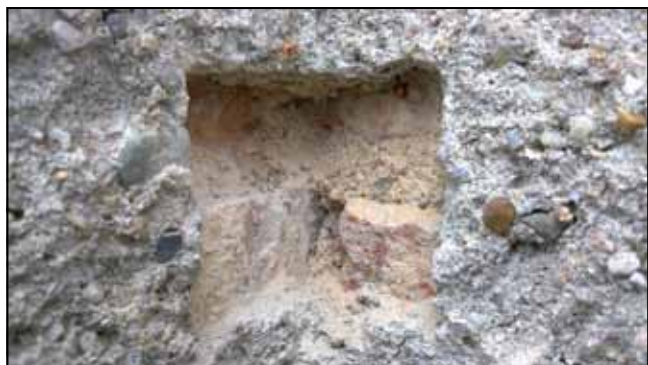
Ryc. 20. Odkrywka nr 11: mur ceglany; zacierana zaprawa wapienno-piaskowa w kolorze ugrowo-beżowym (fuga); rapowany tynk cementowo-wapienny z gruboziarnistym żwirowym wypełniaczem.
