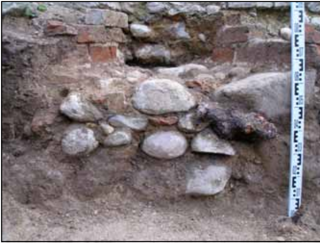
Ryc. 8. Kozuchów, ul. Obywatelska, dz. nr 491/2, basteja, wykop nr 1b, widok od strony zachodniej (na poziomie parapetu) na otwór strzelniczy nr I; widoczne – podkolanek (na pierwszym planie), wykładany eratykami parapet oraz fragmenty ceglanych policzków – północnego i południowego. Fot. J. Lewczuk.
