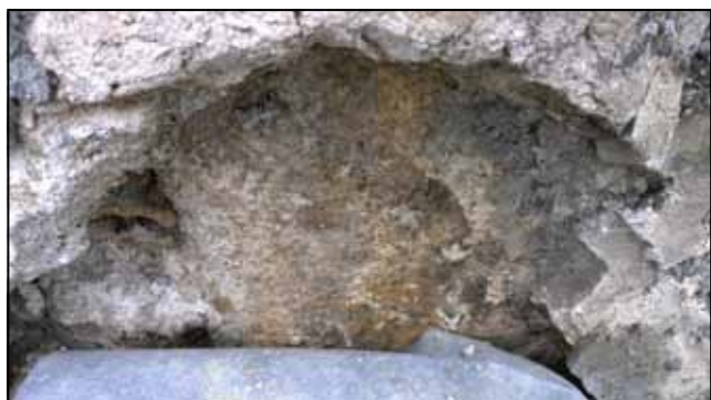
Ryc. 23. Odkrywka nr 19: mur ceglany; zacierany tynk wapienno-piaskowy w kolorze ugrowo-beżowym; rapowany tynk cementowo-wapienny z gruboziarnistym żwirowym wypełniaczem.
