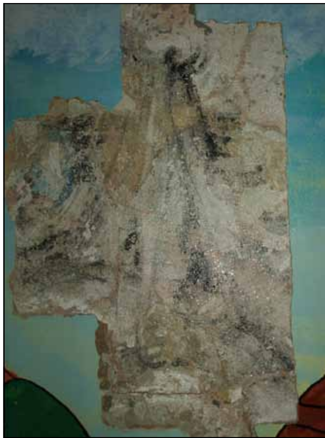
Fot. 7. Znacznie gorzej zachowana dekoracja malarska wykonana w tym samym czasie i należąca do wystroju tego samego pomieszczenia, co zamurowana wnęka okienna z fotografii nr 5 i 6.
