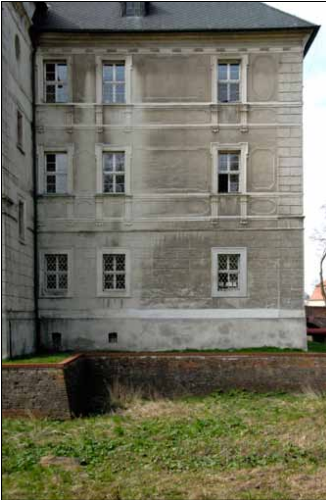
Il. 7. Fragment elewacji pałacu w Zaborze. Stan z 2015 r. Fot. K. Adamek-Pujaszko.
