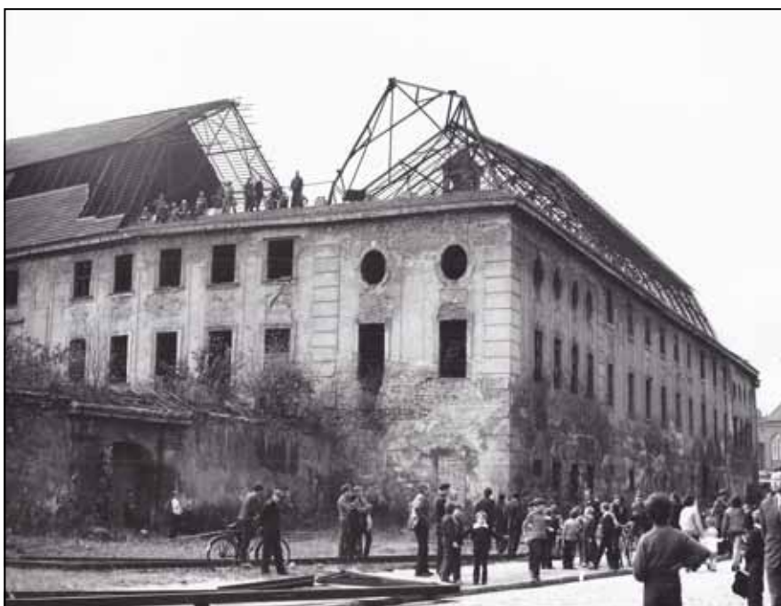
Fot. 10. Remont dachu pałacu w Żarach w latach 60. XX w. Fot. ze zbiorów WUOZ w Zielonej Górze.
