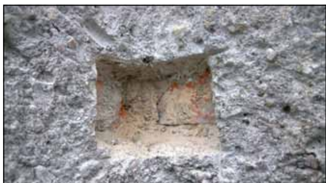
Ryc. 21. Odkrywka nr 16: mur ceglany; zacierana zaprawa wapienno-piaskowa w kolorze ugrowo-beżowym (fuga); rapowany tynk cementowo-wapienny z gruboziarnistym żwirowym wypełniaczem.
