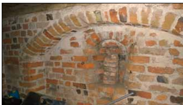
Ryc. 16. Olszyniec – dwór. Pierwsze piętro – zamurwane okno szczelinowe w ścianie północnej, stan w 2014 r.
