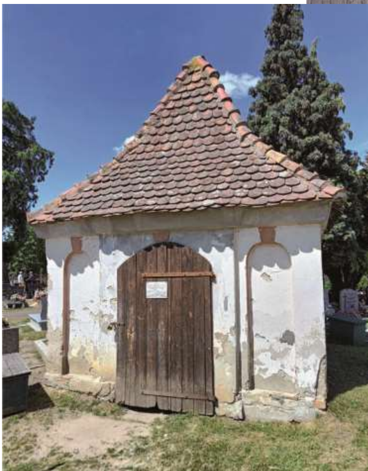
Widoczne zachowane relikty warstwy malarskiej
