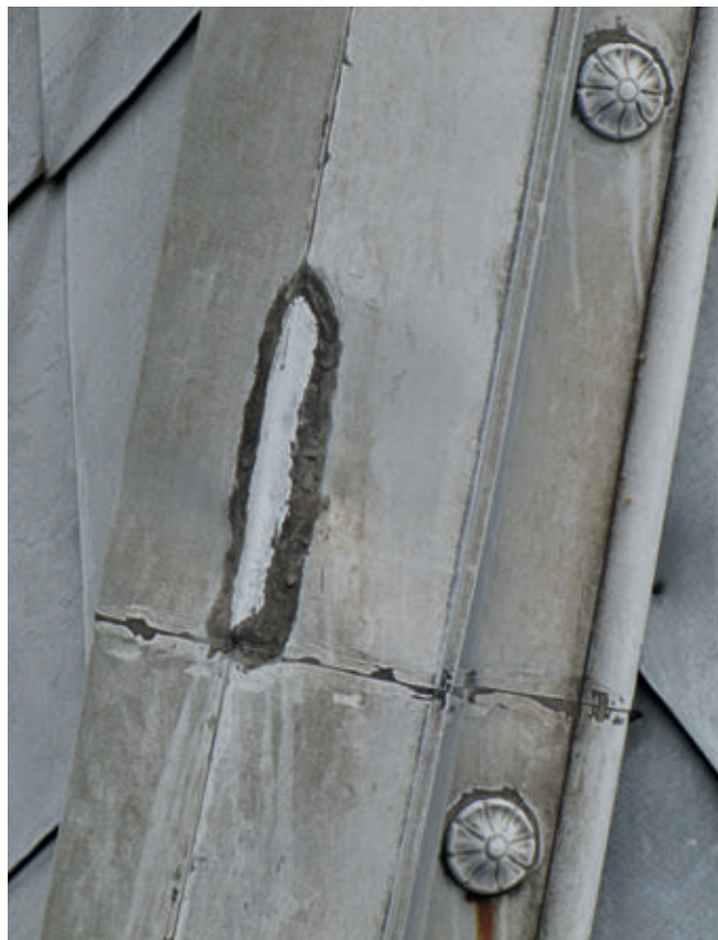
25. Dekoracyjna forma opierzenia blachą cynkową grzbietu dolnej połaci dachu mansardowego pałacu w Trzebiechowie (pow. zielonogórski), 2024
