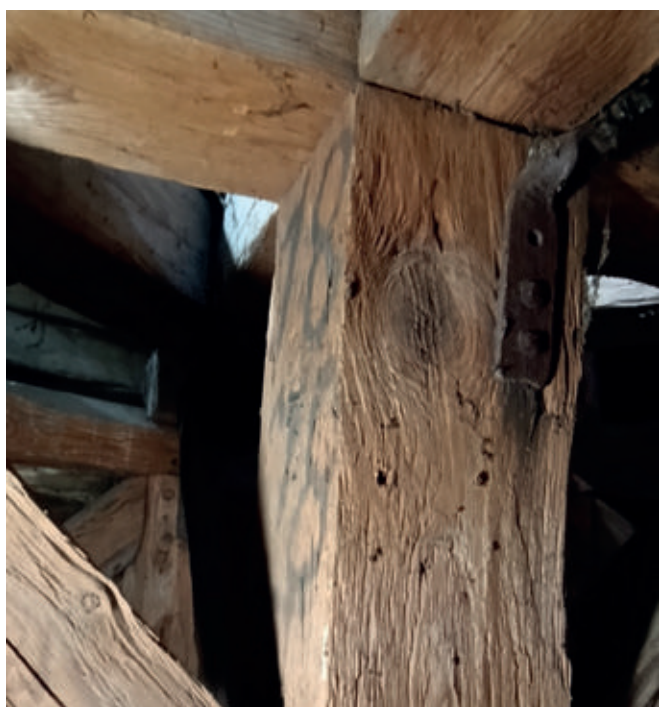
7. Na drewnianym słupie środkowym konstrukcji hełmu namalowane odręcznie liczby w układzie jedna pod drugą 18 | 78, przypuszczalnie data. Dawny kościół ewangelicki w Babimoście (pow. zielonogórski), 2024
