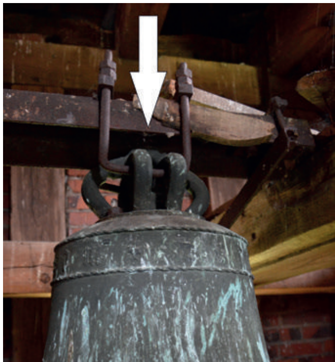
7. Uszkodzona podkładka amortyzująca przy średniowiecznym dzwonie zawieszonym na stalowym wtórnym jarzmie. Przykład skrajnej wady prowadzącej do oberwania się dzwonu. Karczówka, pow. żagański
