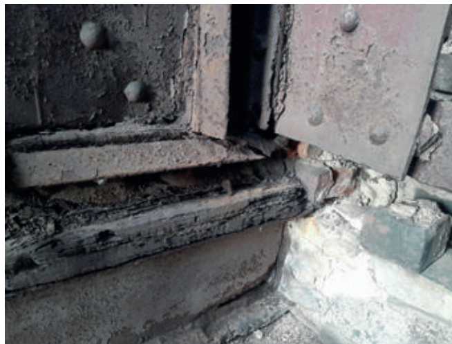
14. Uszkodzona w wyniku korozji podstawa stalowej konstrukcji nośnej oraz widoczny wpływ uszkodzenia na elementy architektury murów nośnych, Świebodzin, pow. loco, kościół Najświętszej Maryi Panny Królowej Polski. Aktualnie (2024) trwają analizy w zakresie przyczyn uszkodzeń konstrukcyjnych murów nośnych wieży tego kościoła. Jednym z hipotetycznych powodów lub też czynników współtowarzyszących może być uszkodzona stalowa koleba
