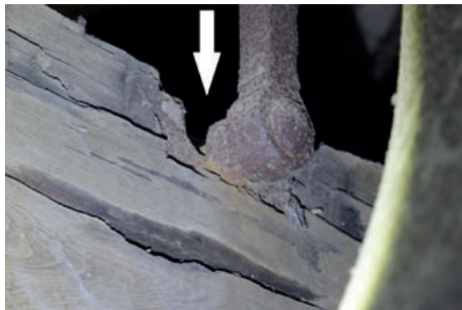
5. Łożysko ślizgowe – „kotyskowe”, widoczna korozja czopa i panewki oraz uszkodzenie konstrukcji nośnej. Koniewo, pow. kamieński
