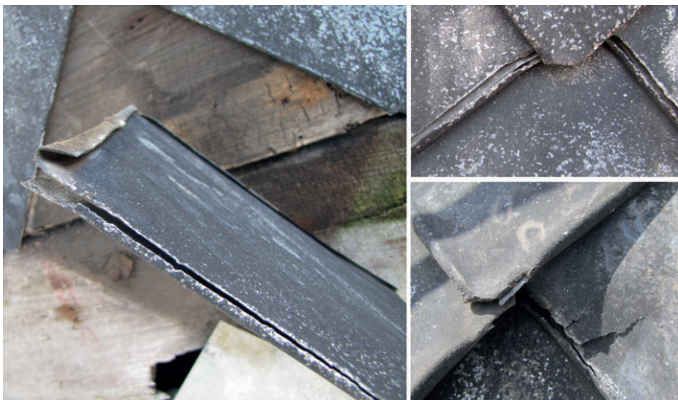
11. Pęknięcia wzdłużne na krawędziach rąbków (felców) arkuszy blachy cynkowej na hełmie wieży dawnego kościoła ewangelickiego w Babimoście (pow. zielonogórski), 2024
