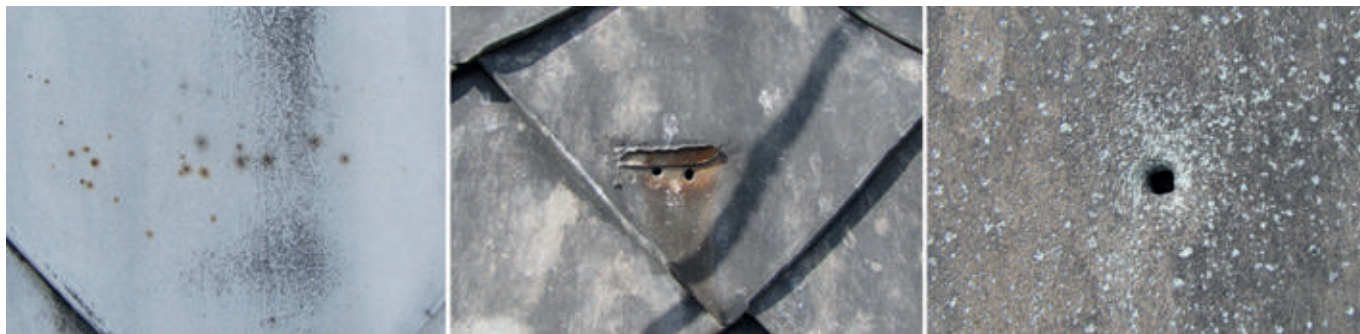
10. Korozja punktowa, perforacje i ślady postrzałowe w historycznej blasze cynkowej na hełmie wieży dawnego kościoła ewangelickiego w Babimoście (pow. zielonogórski), 2024
