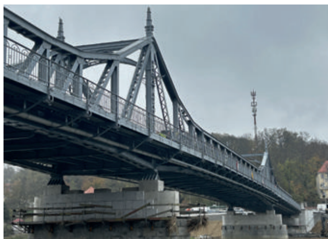
10. Most od strony wody. Widoczny brak uszaków przęsła nadrzecznego
