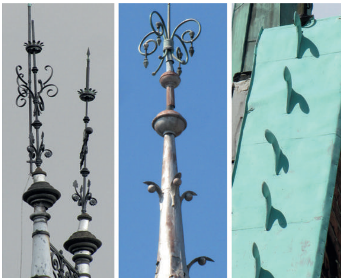
27. Przykładowe formy szpic dachowych (od lewej): pałacu w Trzbiechowie, tzw. willi Oskara Minke przy ul. 1 Maja 22 w Świebodzinie oraz stylizowanej formy czołganki na opierzeniu ściany szczytowej kościoła parafialnego pw. Świętego Krzyża w Żaganiu, 2024 i 2013
